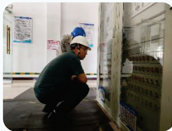
二次設備隱患排查
